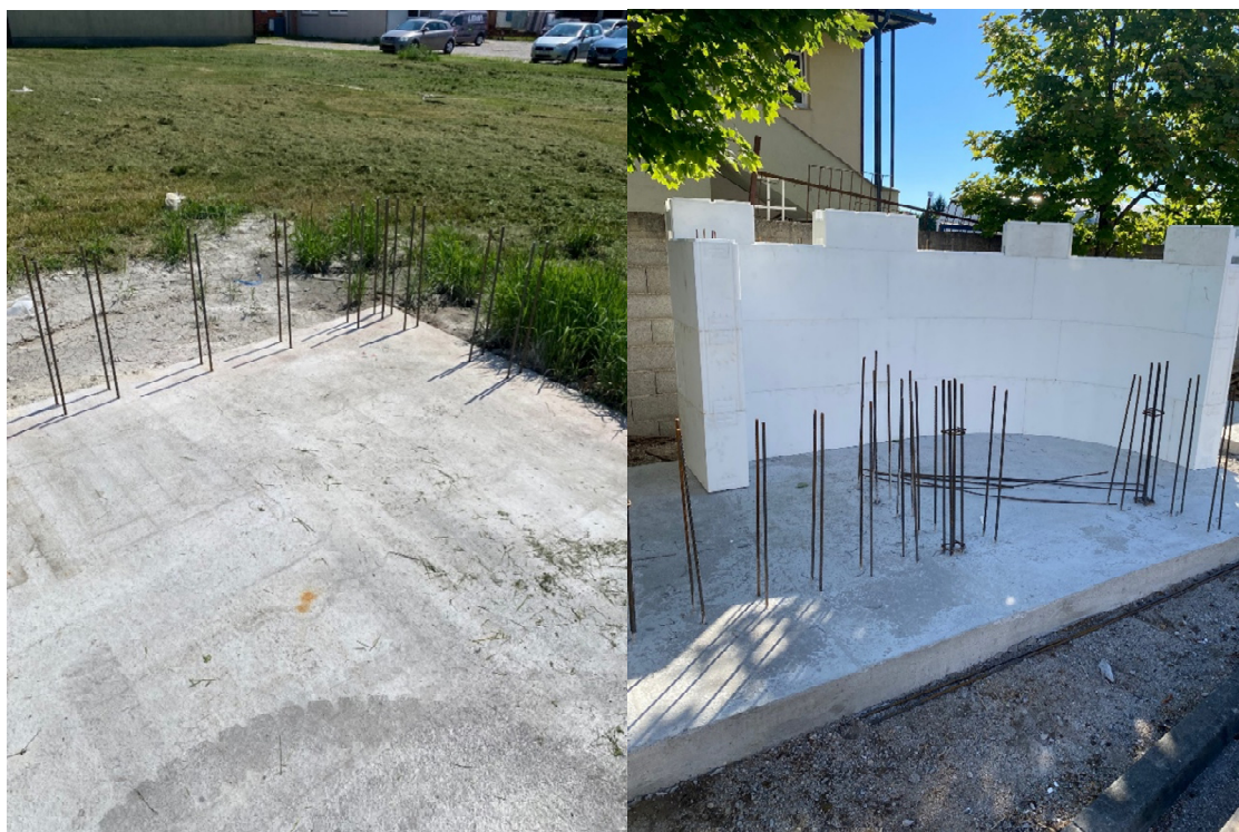
Slika 7: Armatura iz betonske ploče
